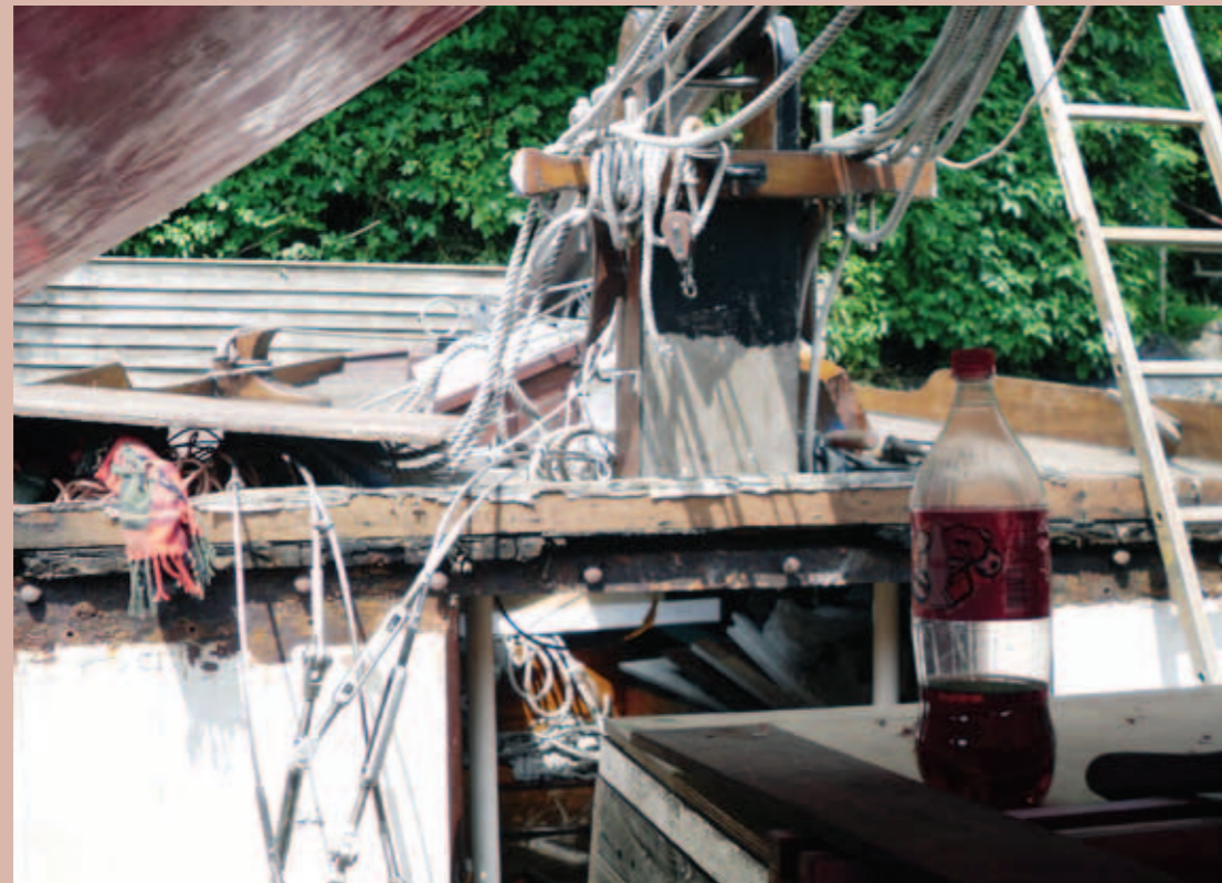
Fig. 6 De waterlijst is hier verwijderd. Op de voorgrond de stagen. Hier is ook de slechte staat van de afsluiting naar het vooronder te zien.
